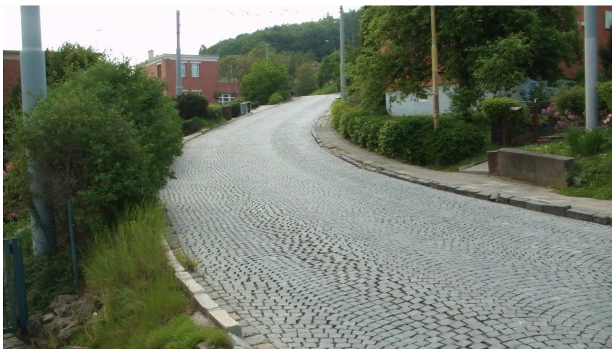
Obrázek 16: Nevhovující kvalita povrchu chodníku v ulici Lesní čtvrť 1
