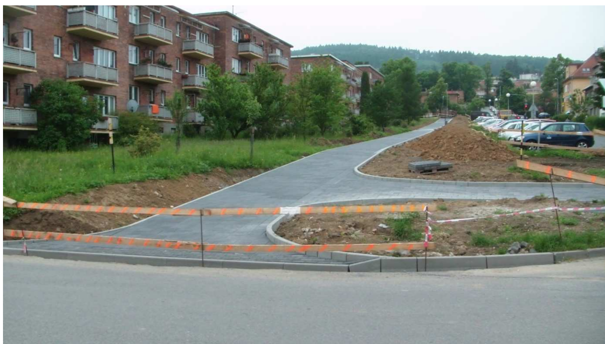
Obrázek 8: Neúplnost prvků v místě pro přecházení na ulici Kvitková (komunikace ve stavbě)
