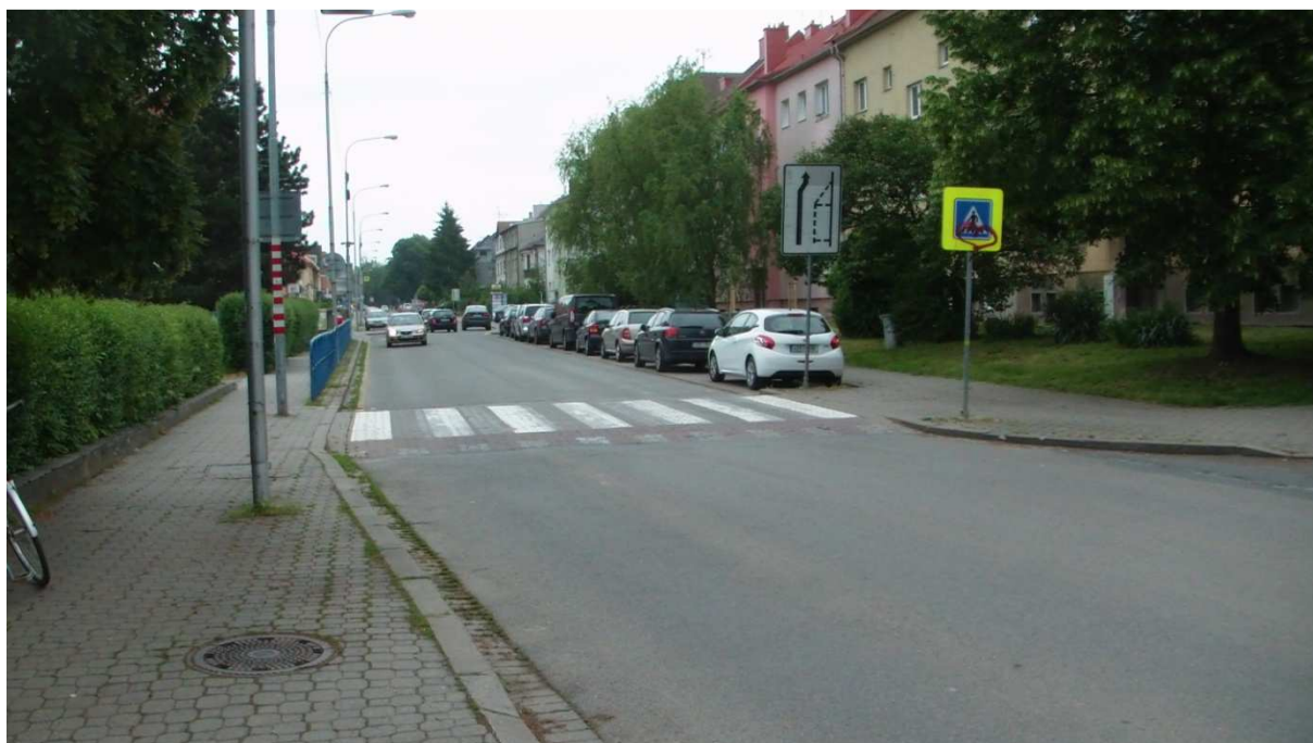
Obrázek 6: Chybějící prvky na přechodu v ulici Kvítková
