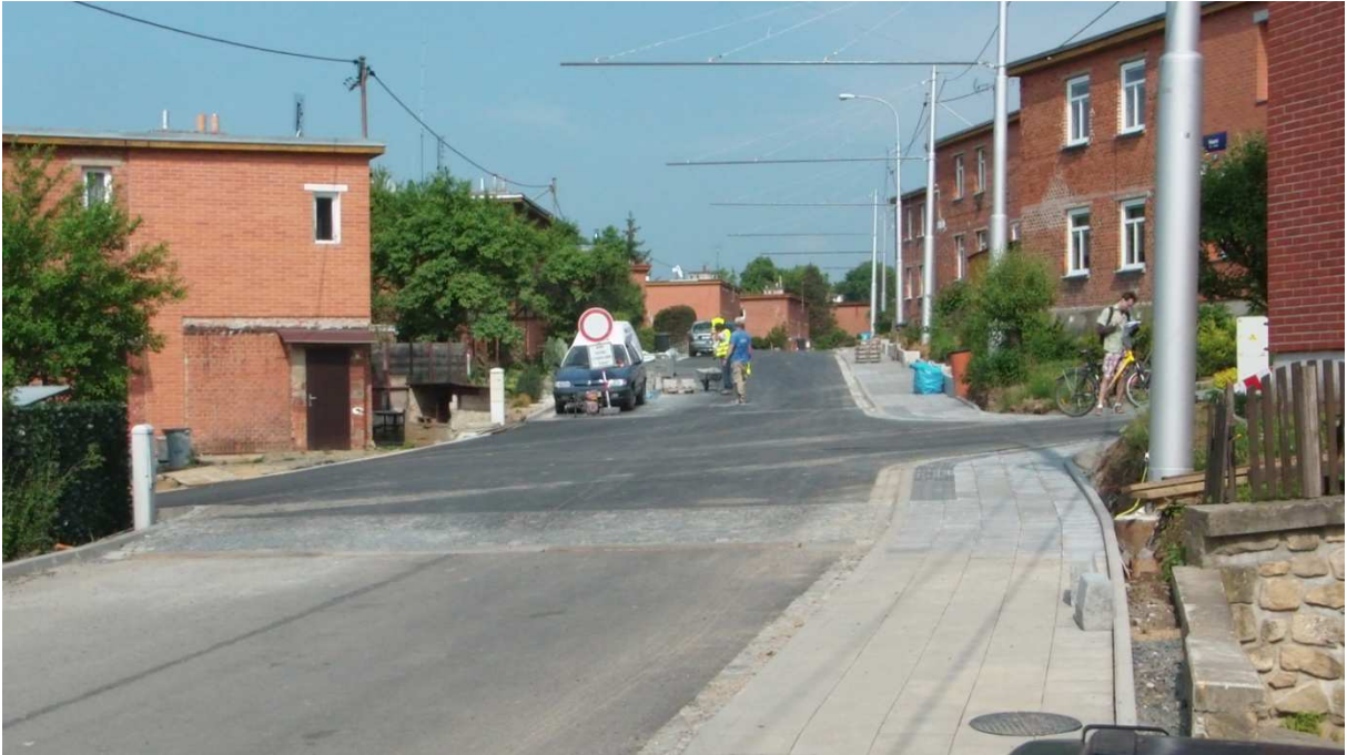
Obrázek 9: Neúplnost prvků v místě pro přecházení na ulici Mostní (komunikace ve stavbě)
